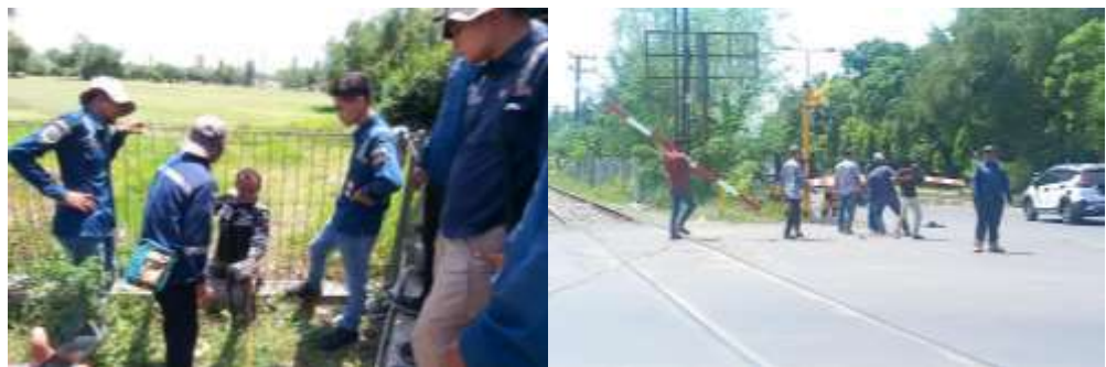
Gambar 2. 2 Dokumentasi Uji Pertama Fasilitas Operasi Palang Pintu Perlintasan Sebidang pada Lintas Kreung Geukeh – Muara Satu
