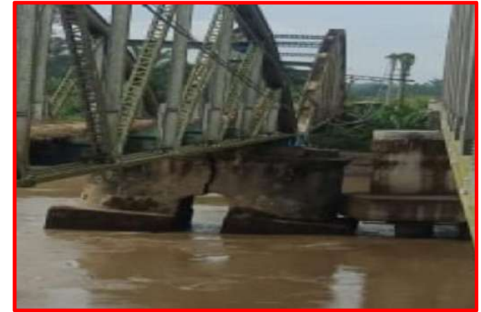
Kondisi Jembatan BH 44 yang terdampak Luapan Sungai Wampu dan mengakibatkan kerusakan
